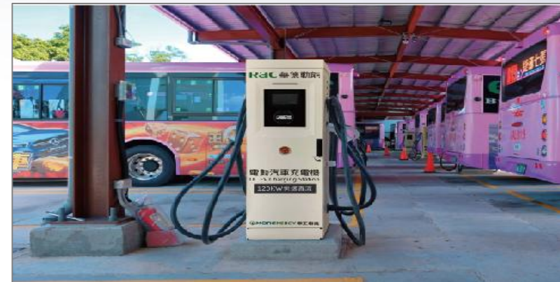
OCPP CCS1充電機
