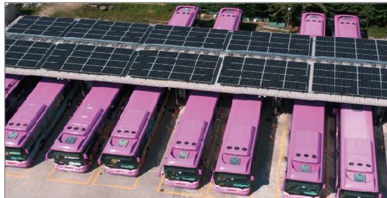
太陽能發電系統
